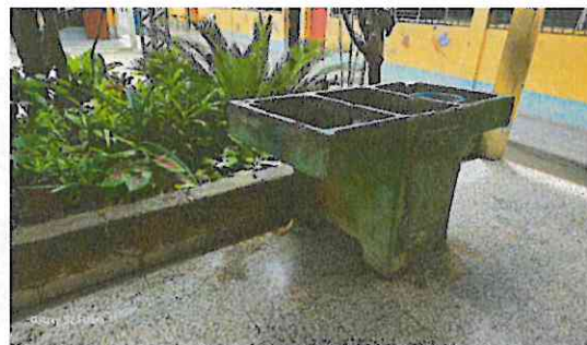
Foto 6: Drenaje de sanitarios deteriorado
