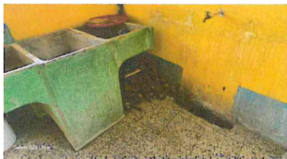
Foto 5: Drenaje de cocina deteriorado
